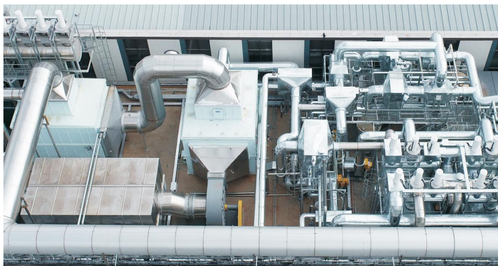
浙江坤孚 DMF/甲苯回收治理工程（2023）
