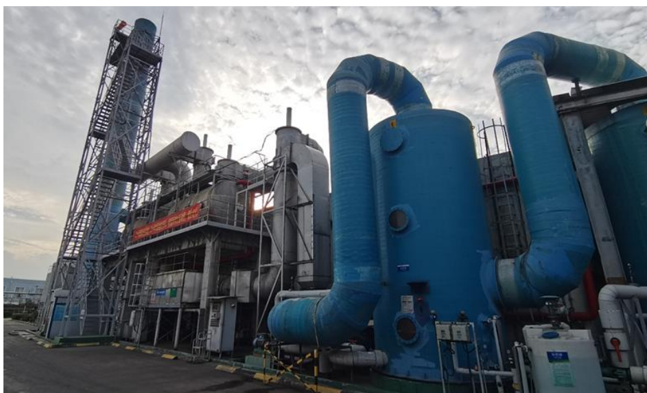
南通润启环保服务有限公司废气处理系统改造项目（2023）
